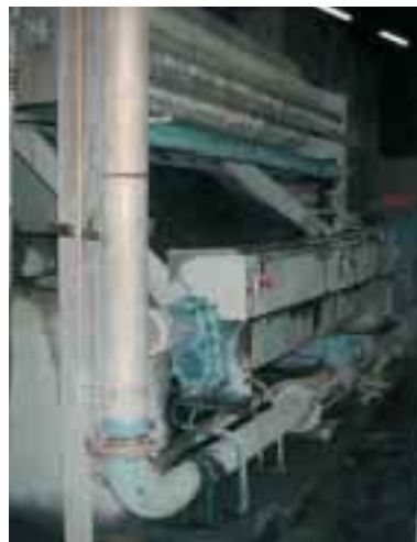
Gavopump (GBB) under filter press
